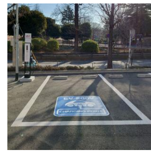
▲EV充電スタンド
